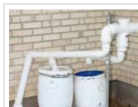
Dispositivo de descarte de água das primeiras chuvas, utilizando bombonas plásticas. Clique na imagem para ampliar
