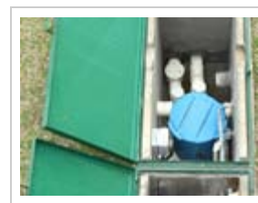
Vista interna da cisterna identificando-se o dispositivo de descarte de sólido e a motobomba. Clique na imagem para ampliar
