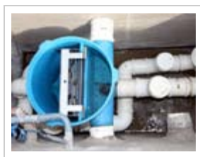
Dispositivo de Descarte de sólidos instalado do interior da cisterna. Clique na imagem para ampliar
